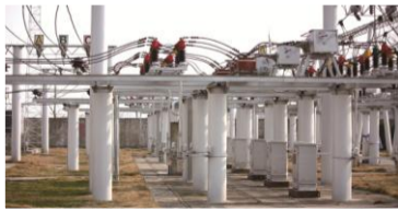
220千伏输变电站
